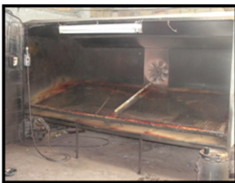
Foto No. 8 Cabina de pintura.
