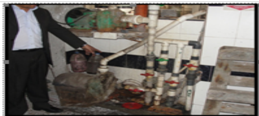
Foto No. 2 Sistema de bombeo de aguas residuales.
