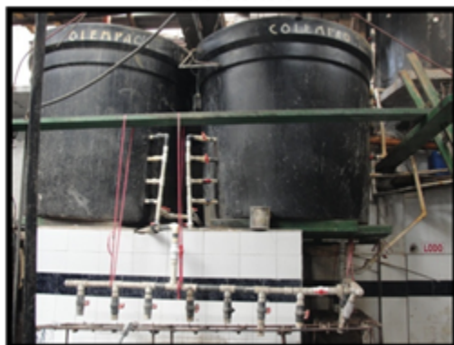
Foto No. 5 Tanques de tratamiento fisicoquímico.
