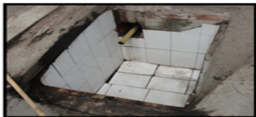
Foto No. 3 Caja de inspección externa. lodos activados.
